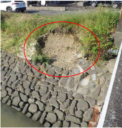
左岸護岸上部崩壊
